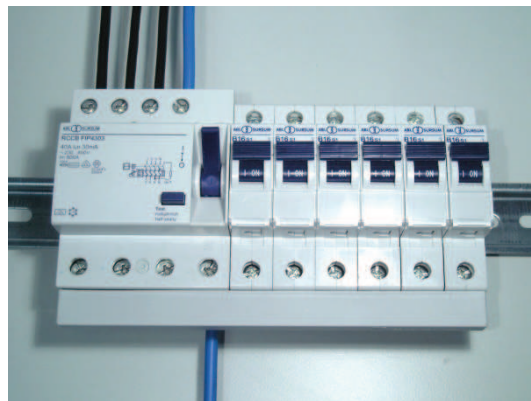
Połączenie szynami fazowymi
